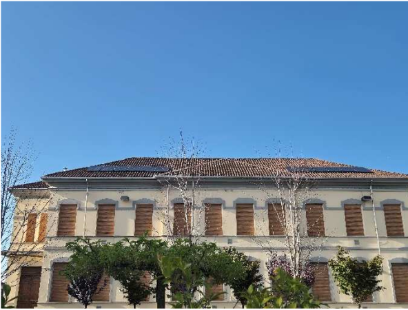
Riqualificazione energetica – Installazione pompa di calore con moduli fotovoltaici Scuola Elementare “A. Ferrari”
