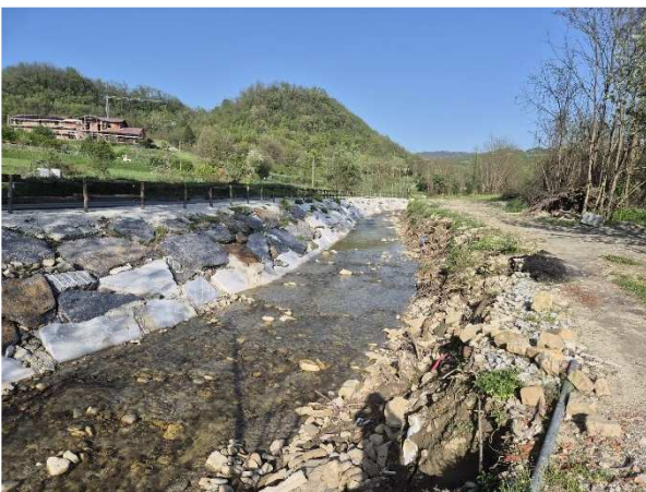
Sistemazione idrogeologica del Rio Vargo con ripristino viabilità strada comunale del Gerino
